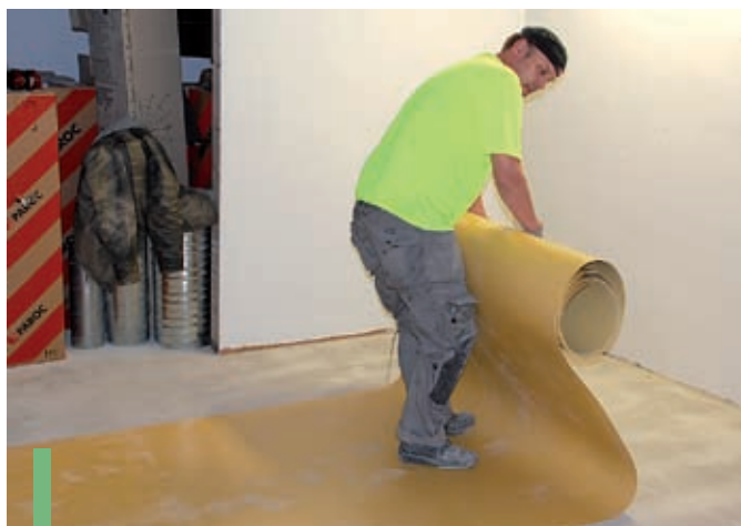
Tammikuussa avattavassa rakennuksessa tehdään vielä sisätoivia. Ilkka Nurminen levittää paikalleen luokan lattiaa.
